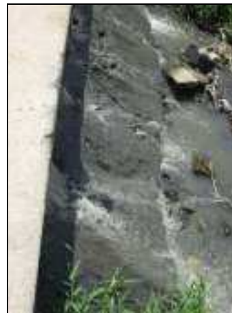
Foto 3.83 – Lançamento de Esgoto na Rua José Viera de Melo
