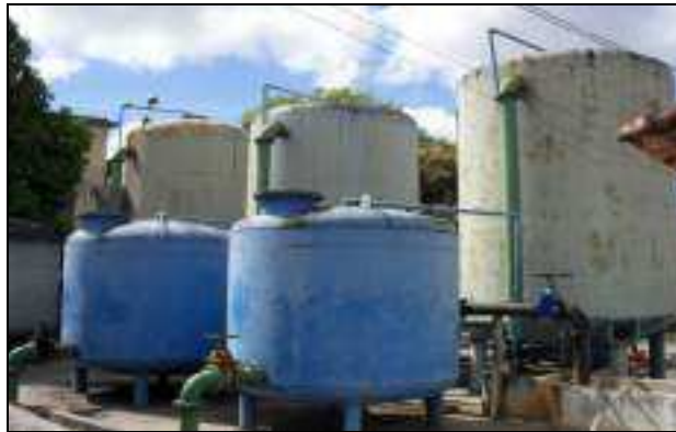
Foto 3.74 – Visa Geral da ETA Compacta
